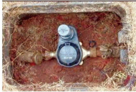
Meteran air terpasang di tanah
