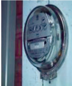
Meteran listrik terpasang di dinding
